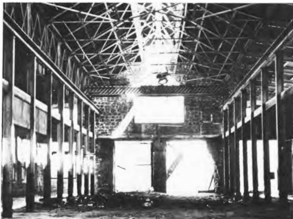
On peut voir l'intérieur du bâtiment #4 avec la structure, les mezzanines et le pont roulant.
