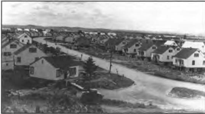
Installation des maisons Wartime d'Arvida sur des fondations, en 1949 : le chantier fit sensation dans la presse.
