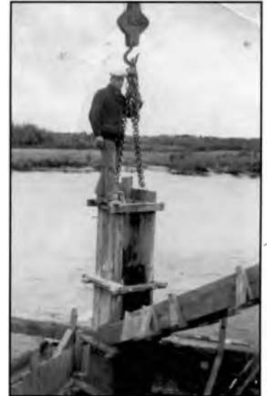
La construction du premier pont de béton sur la rivière Ouiatchouan en 1940.
